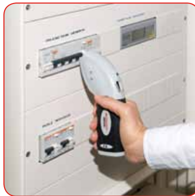
2-Detecte el fusible o interruptor
