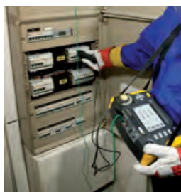
Maintenance tertiaire & industrielle, diagnostics & contrôles
